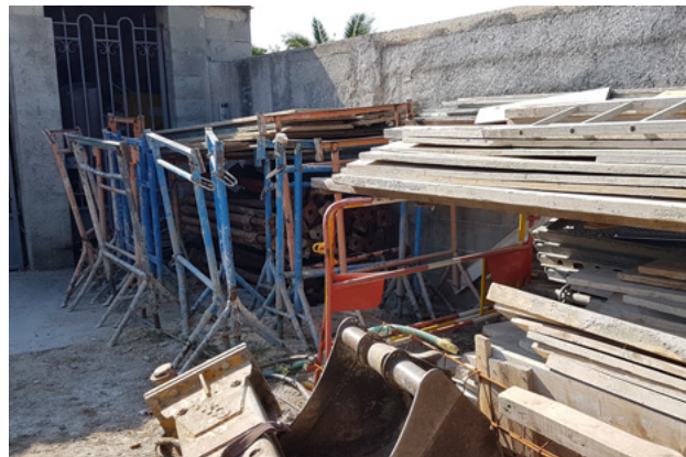
Matériels de chantier laissés à l'air libre à proximité des habitations
