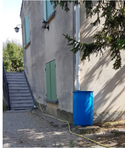
Récupérateur d'eau de pluie sous une descente d'eau pluviale
