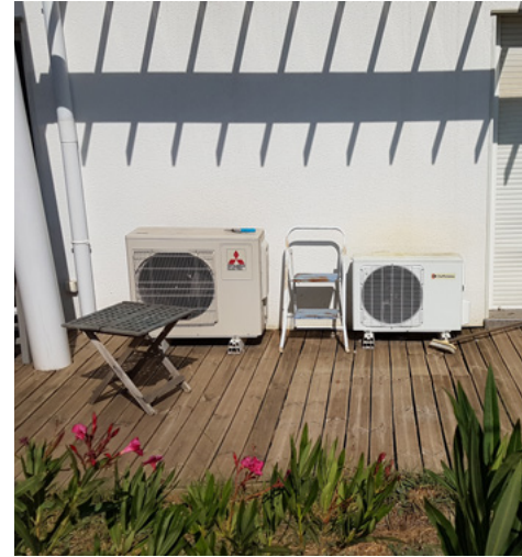
Éléments externes de climatisation posés sur une terrasse lames de bois
